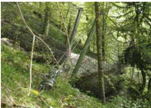
Abb. 13: Stahlnetze, oft schon reichlich (hier mit Ramsaudolomit-Schutt) hinterfüllt, sollen die Kunsteisbahn vor Steinschlag schützen. Der Bebauungsplan der Kunsteisbahn endet knapp hinter den Netzen.
