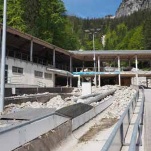
Abb. 4: Im Tobel ist die Betonschale der Bahn am 11.05.2022 teilweise geräumt. Über dem Querbau erkennt man die Bahn der Hauptmure.
